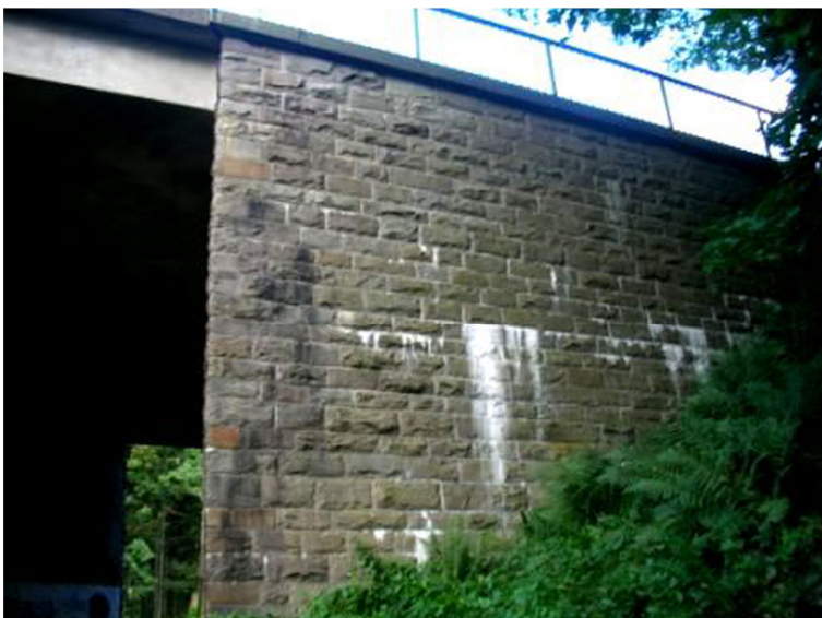
Ebenfalls deutlich zu sehen wie baufällig diese Brücke ist
